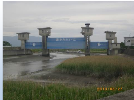
⑤佐賀県 防潮水門の長寿命化
